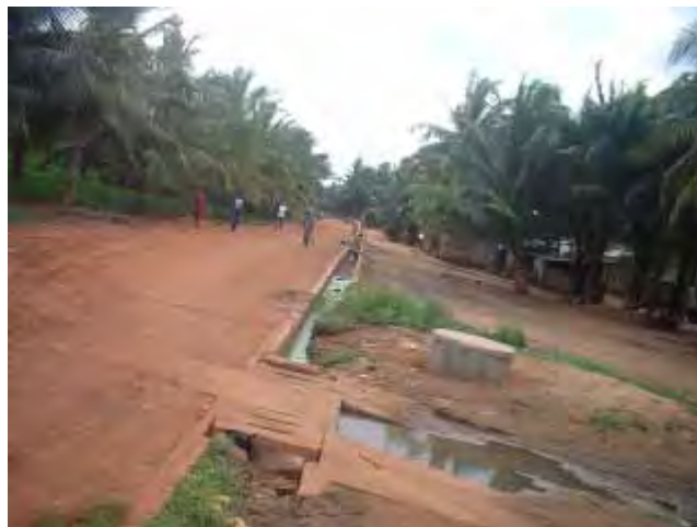
Photo 2 : Exutoire et caniveau ensablés
