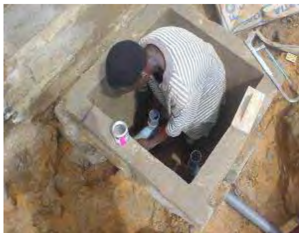
Photo 5 : Regard de branchement
