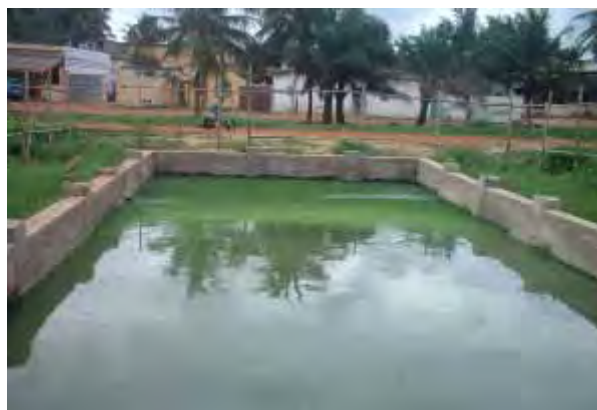
Photo 7 : Bassin de traitement.
