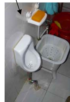
* Urinoir intégré dans chaque salle de bains
