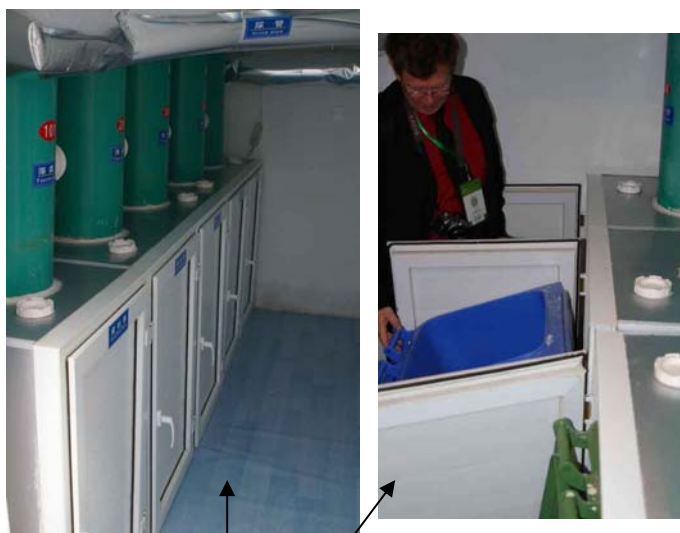
* Récupération de la matière fécale dans des bacs au sous-sol. Les chambres sont ventilées.
